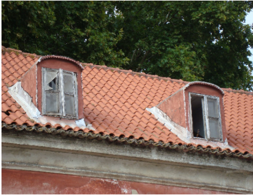
© Foto do Autor (12/9/2009) – Edifício em degradação.
