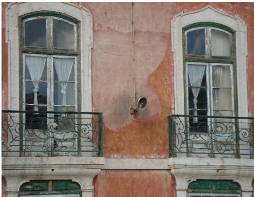
© Foto do Autor (12/9/2009) – Edifício em degradação.
